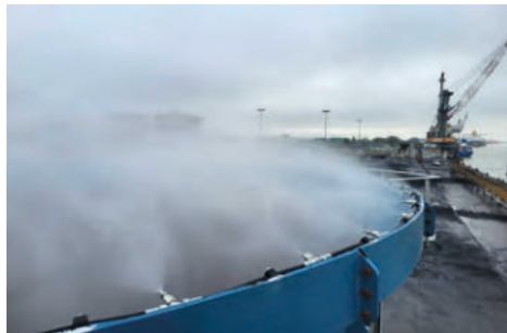
Rampe de diffusion souple sur trémie
