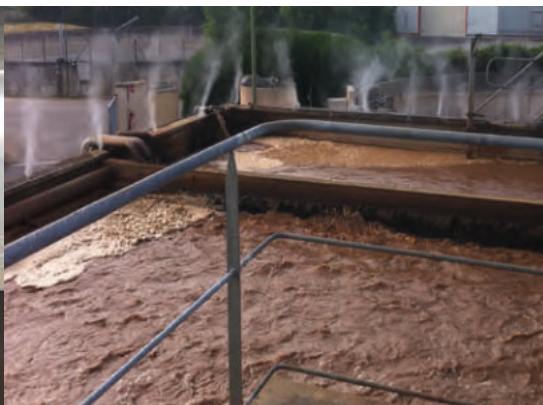
Traitement d'odeur - épuration
