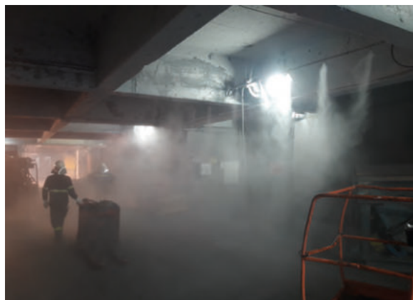
Refroidissement - Rampes de brumisation
