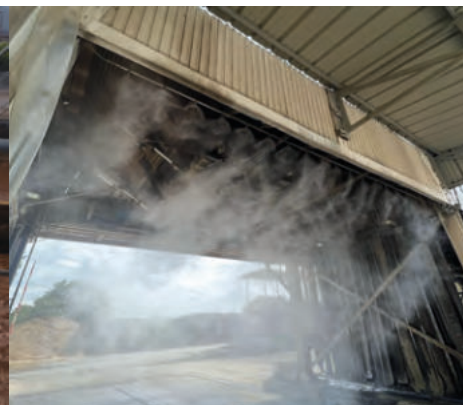
Traitement d'odeur - enrobé
